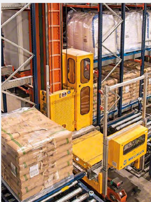
Rys. 3.42. ASRS z systemem Pallet Shuttle w magazynie o wysokości ponad 40 m firmy Mecalux
